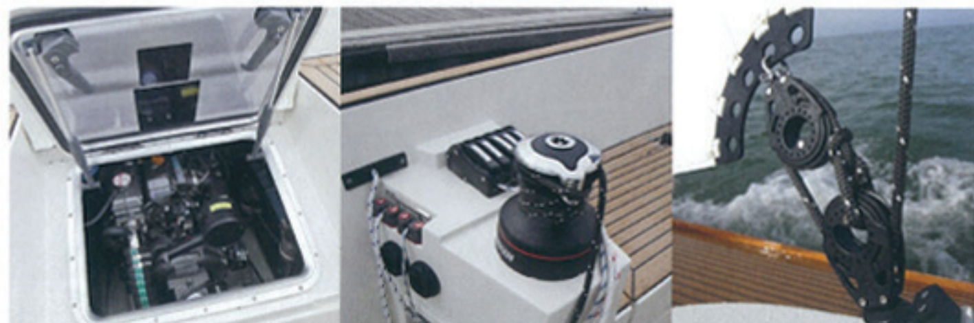
BOVEN Dankzij een luik is de motorruimte waterdicht afgesloten, maar wel heel goed bereikbaar.
